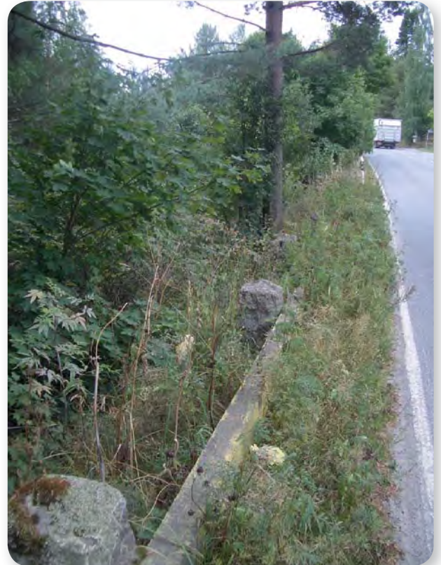
Kuva 63. Kunnostettavaa kaidetta Annilan kohdalla
